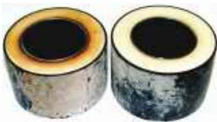
Vor- und Rücklauf des 30 Jahre alten Kunststoffverbundmantelrohres
