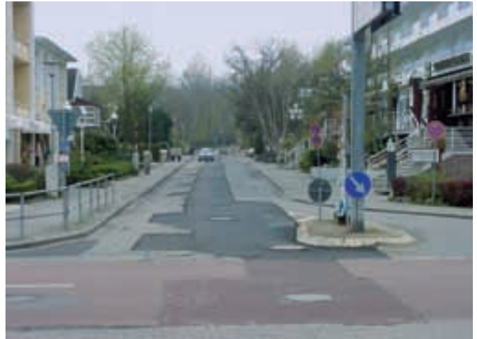
Abb. 2: Typisches Bild einer Straßenoberfläche nach „offenem Eingriff“ (Schmallenberg/ Sauerland)
